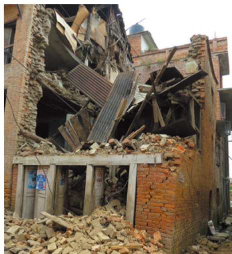
2 2015年のネパール大地震でくずれた建物(写真提供: JICA)
